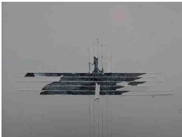
Bild V: Haftungsverlust infolge mangelhafter Vorbehandlung und Verwendung ungeeigneter Anstrichstoffe
