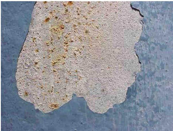
Bild XI: Schadensbild auf Handlauf infolge mangelhafter Vorbehandlung und 2K-Beschichtungsaufbau mit Applikationsmängel
