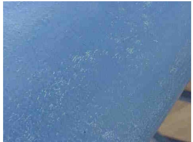
Bild XII: Mangelhaft ausgeführter 2K-Beschichtungsaufbau auf Feuerverzinkung
